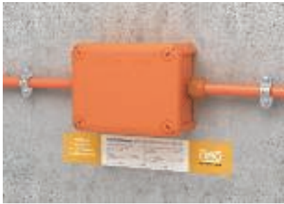
Fertig installierte FireBox mit Kennzeichnungsschild
